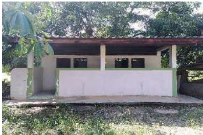
อาคารอเนกประสงค์ สปช. ๒๐๒/๒๖ ปีที่สร้าง ๒๕๒๙
